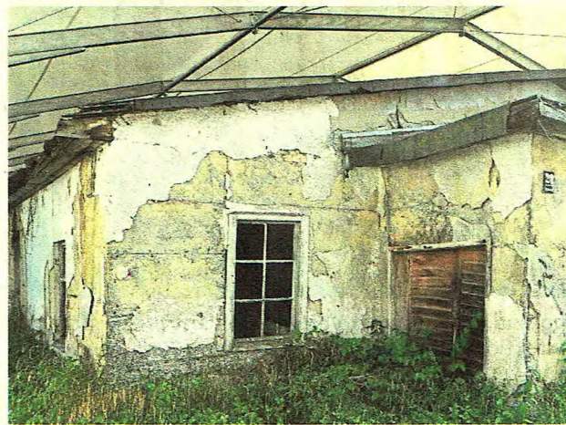
Die einsturzgefährdete Sabathiel-Baracke, die letzte verbliebene Gefangenenunterkunft des Stalag VII A, könnte nach den Vorstellungen von Experten mit einem Infobereich für Besucher ausgestattet werden. FOTO: BAUER
